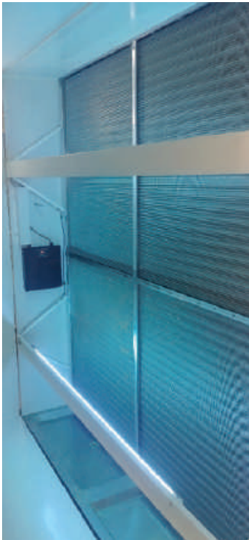
Serpentín con dos filas de lámparas instaladas.
